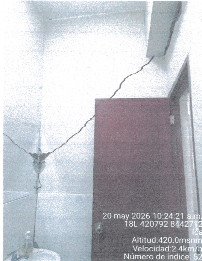
Foto 08: Presencia de fallas en los muros de albañilería (esfuerzo cortante – forma de X) debido a la fuerza sísmica en dirección del eje principal del muro (falla x tracción diagonal)
