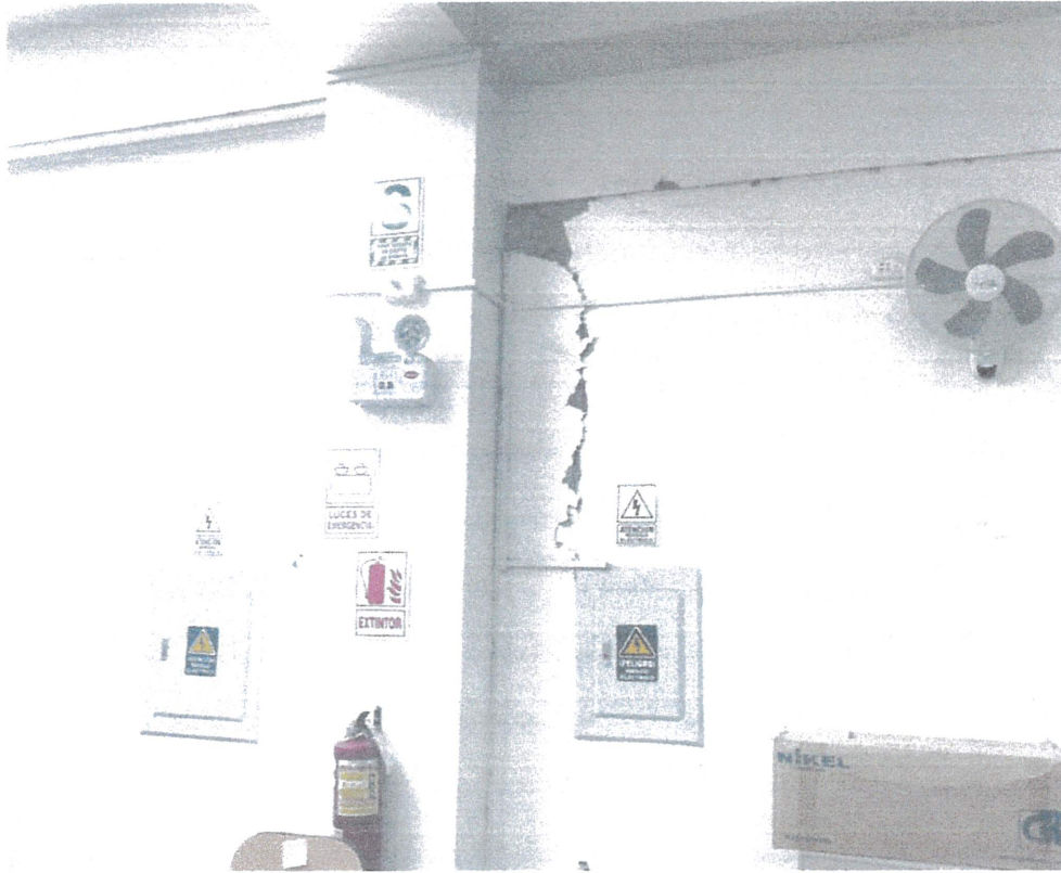
Foto 16: Presencia de fallas en junta fría entre el muro de albañilería y viga principal en la biblioteca central y posible fuerza vertical del sismo.
