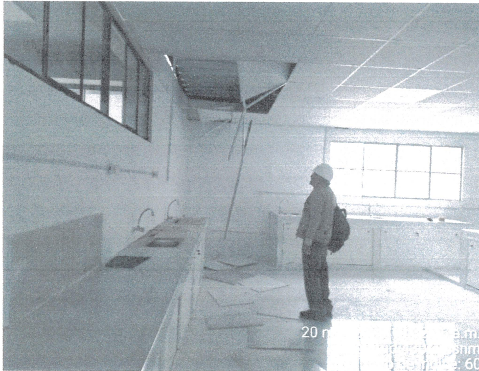
Foto 07: Baldosa de cielo raso se desprendieron de rieles y anclajes.
